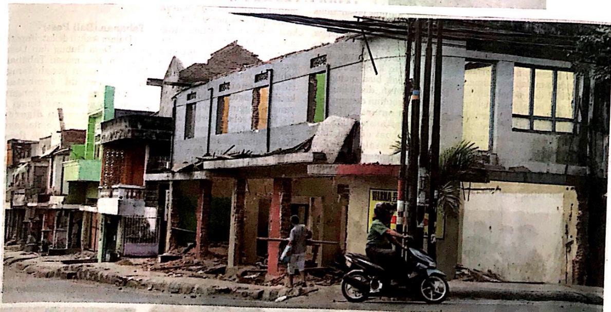
REVITALISASI - Delapan perusahaan dinyatakan lolos kualifikasi tahapan tender konstruksi megaprojek revitalisasi Pasar Banyuasri. BLP menargetkan pertengahan November 2019 sudah diumumkan pemenang lelang megaprojek senilai Rp 180 miliar ini. Bali Post/mud
