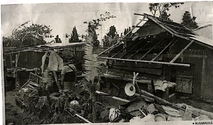
ASESMENT dari tim BPBD Buleleng di sejumlah bangunan yang rusak, Senin (21/10), akibat dampak angin kencang yang menyapu daerah puncak Buleleng.
