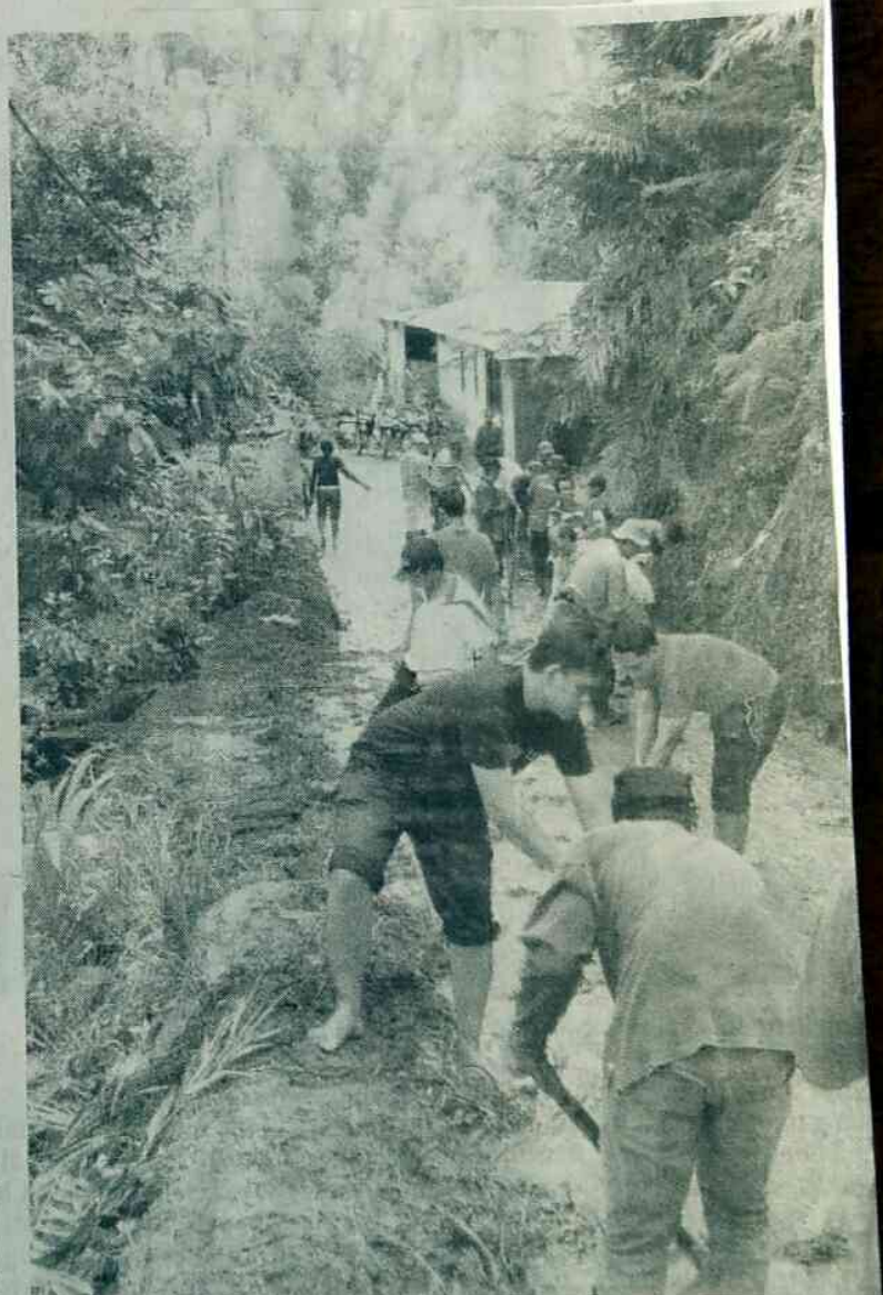
Kegiatan gotong-royong lokasi longsor di Banjar Dinas Bulakan, Desa Munduk, Kecamatan Banjar.
